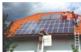
PV-Anlage Altstadt Leistung: 2,8 kW Jahresertrag: 2.380 kWh
