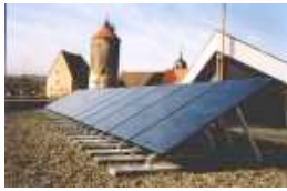
PV-Anlage Besigheim Leistung: 2,70 kW Jahresertrag: 2.160 kWh
